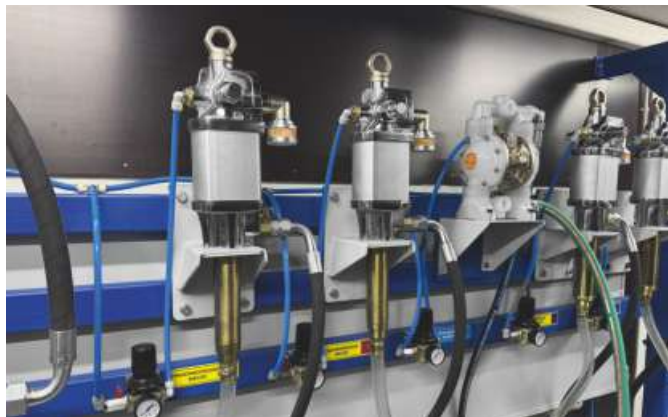
Посты раздачи трансмиссионного масла, моторного масла и охлаждающей жидкости
